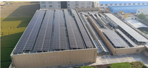
公司光伏发电项目
